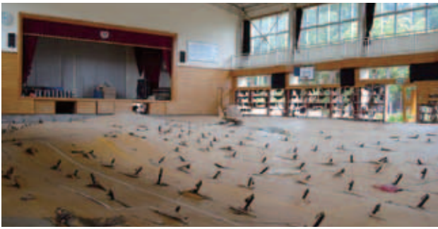
被災した体育館。壁は崩れ、床板は波打つように盛り上がり、床下の柱が飛び出している。
